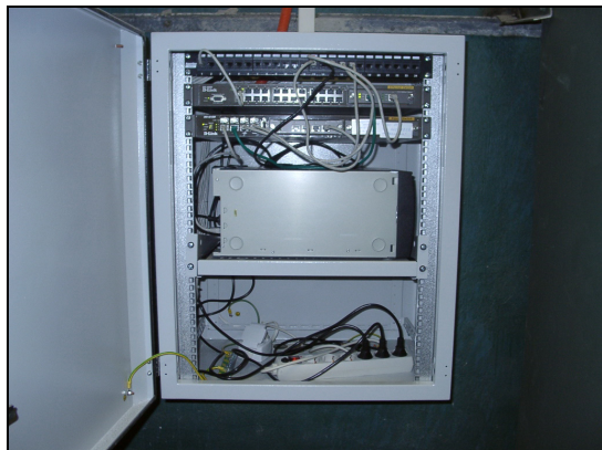
Рис. 2.3. Шкаф с сетевым оборудованием
